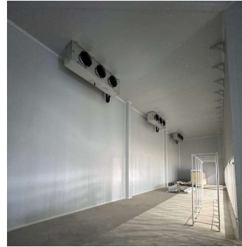
CÁMARA DE BAJA TEMPERATURA
